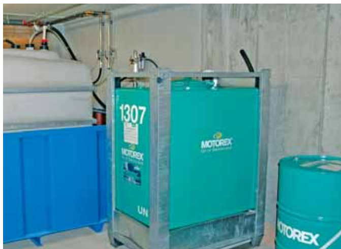
Det centrala lagret för bearbetningsvätska i källaren reducerar logistikkostnaderna betydligt. Leveranser till och från lagret kan ske rationellt och i full överensstämmelse med gängse säkerhets- och miljöstandard.
