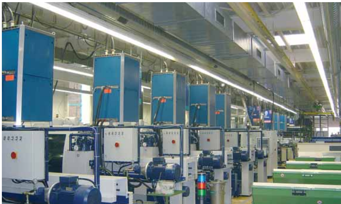
Alla maskiner är anslutna till centralt utsugssystem och körs med högsta precisionsnivå dygnet runt.
